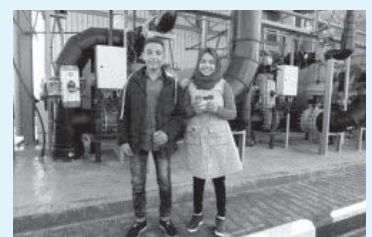
© UNICEF State of Palestine/2017/Weibel 地下水の過剰な汲み上げが原因で、下水や化学物質を含む地中海の塩水が土壌に浸透し飲み水が汚染されてしまったガザ地区。海水の水を淡水化する「脱塩浄水場」が2017年に完成、安全な水を届けている。(パレスチナ)
